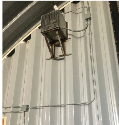
K-Span II Ventilation Fan
